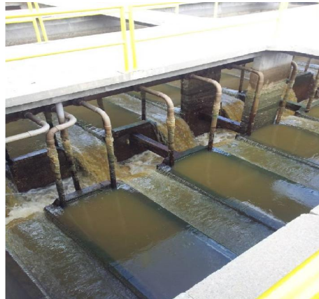
Figura 8 - Filtro em processo de lavagem. Fonte: Autora do trabalho.
