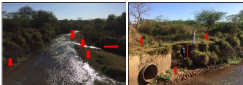
Figuras: 03 - evidenciado a escassa mata ciliar e o assoreamento na margem direita do córrego Caveirinha, sentido leste. 04 - processos erosivos na margem esquerda, próximo ao sistema de captação das águas pluviais. Foto: Rosa, 2018.
