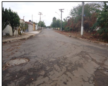
Figura 4. Evidenciando a calçada destruída e o asfalto com rachaduras provavelmente em consequência da associação entre solo colapsível e escoamento pluvial. Foto: Roque, 2018.
