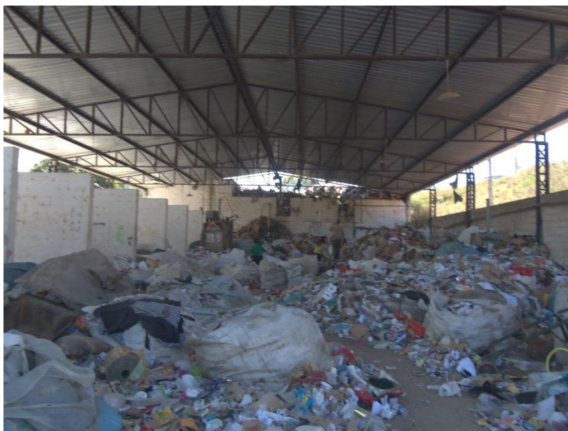
Figura 7: Vista interna dos resíduos espalhados e bags no interior do galpão. Fonte: Autores do Trabalho.
