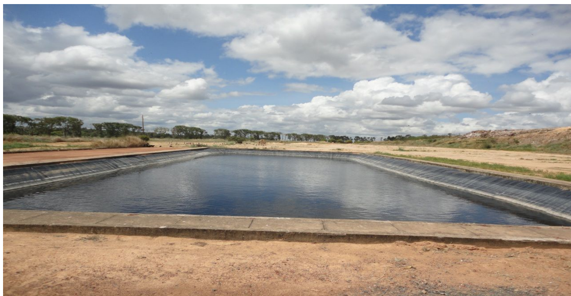
Figura 2: Vista da Estação de Tratamento de Chorume – ETC, por meio de lagoa anaeróbia do aterro sanitário de Boa Vista/RR.
