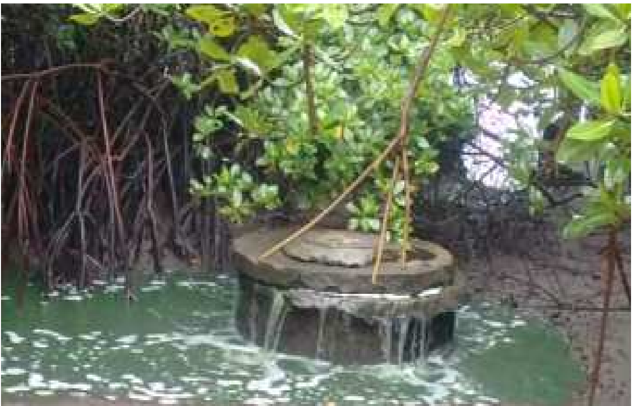
Foto 9 - Manilha despejando efluentes dentro do mangue - Coordenadas Geográficas: 8°44'2'' S e 35° 6' 18'' W Fonte: Souza. J. L. F de
