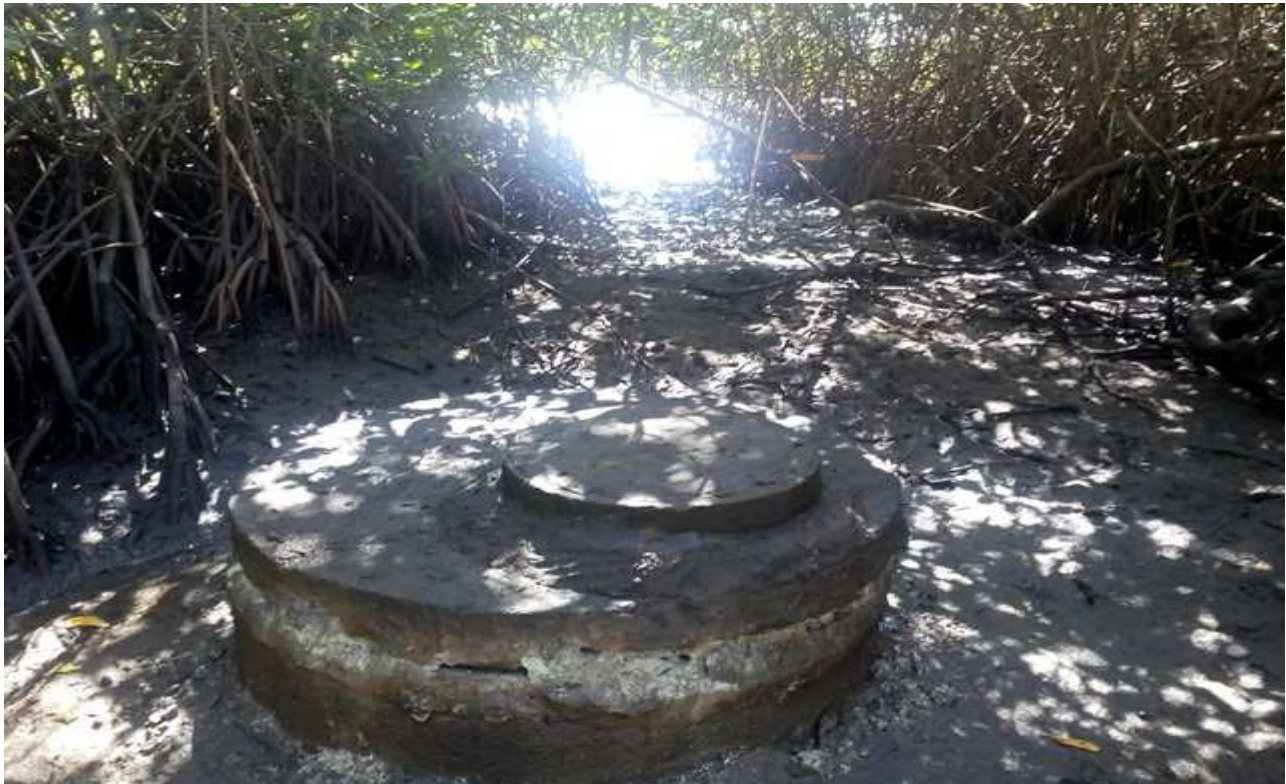
Foto 6 - Manilha que despeja efluente dentro do mangue - Coordenadas Geográficas: 8° 44 '2'' S e 35° 6' 18'' W Fonte: Souza. J. L. F de
