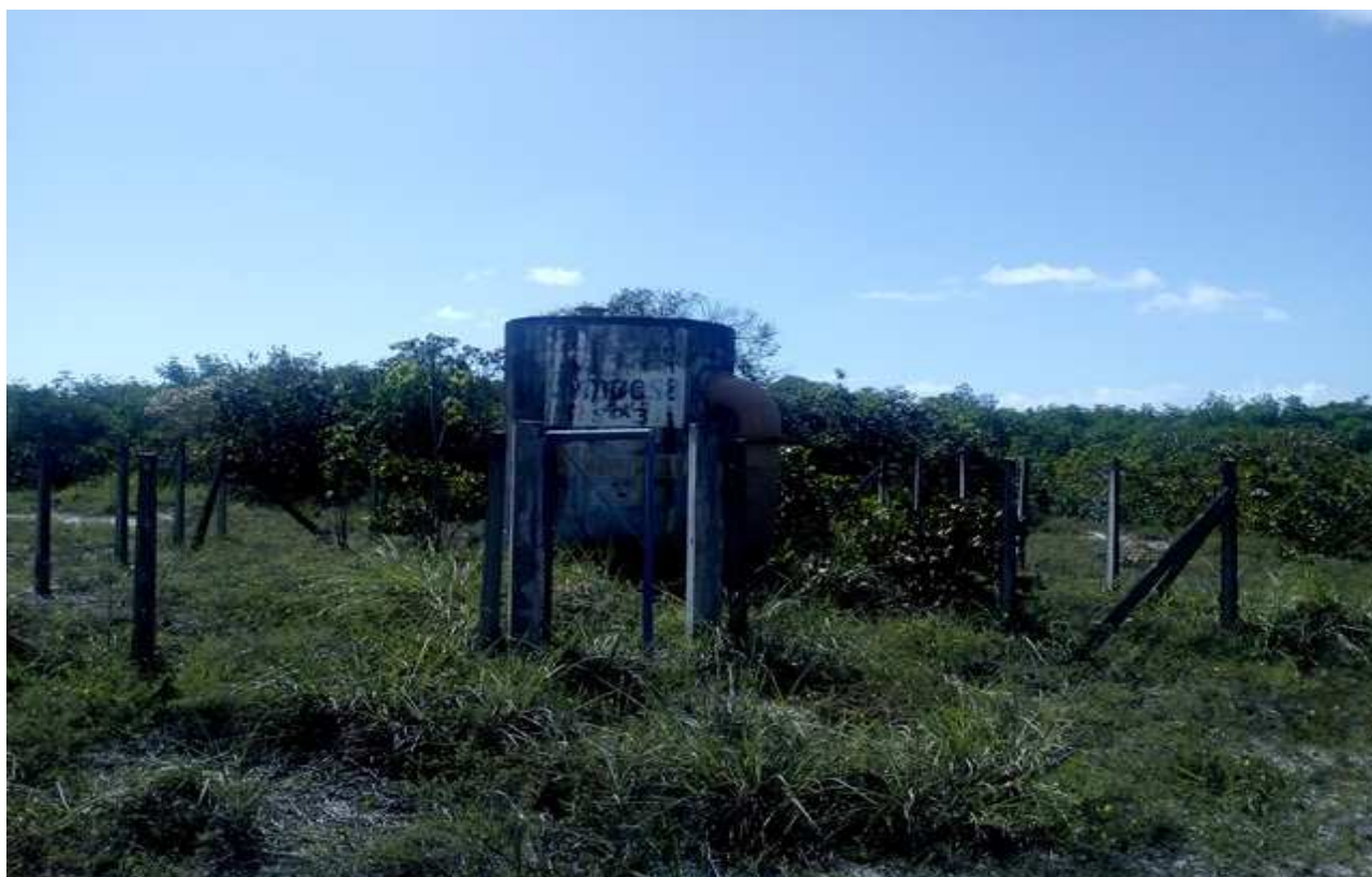
Foto 1- Acesso a manilha que despeja efluente no Mangue - Coordenadas Geográficas: 8°43'58" S e 35° 5' 47" W Fonte: Souza. J. L. F de
