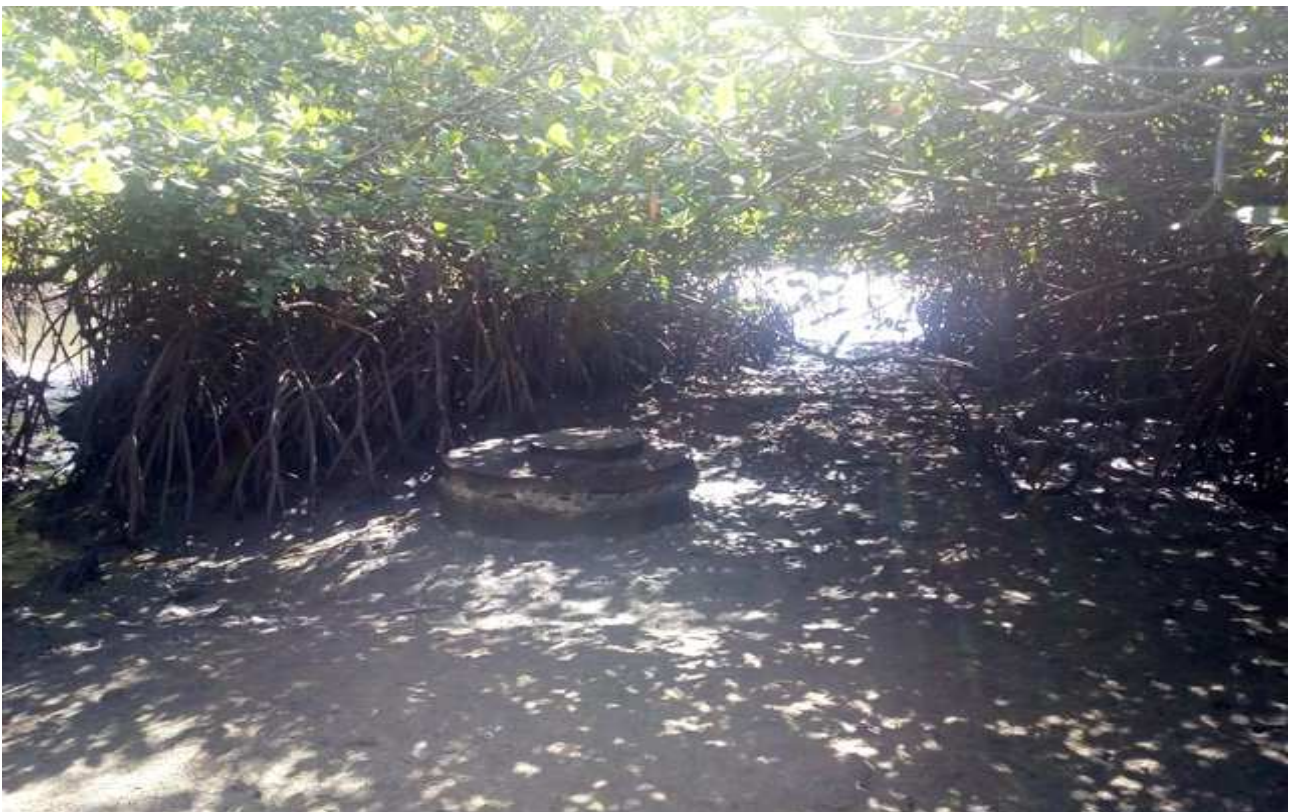
Foto 5 - Manilha que despeja efluente dentro do mangue - Coordenadas Geográficas: 8° 44 '2'' S e 35° 6' 18'' W Fonte: Souza. J. L. F de
