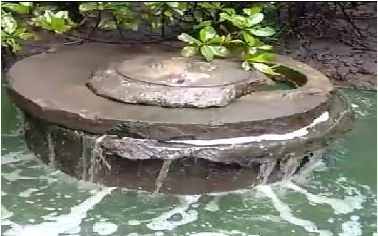
Foto 7 - Manilha despejando efluente dentro do mangue - Coordenadas Geográficas: 8°44'2'' S e 35° 6' 18'' W Fonte: Souza. J. L. F de
