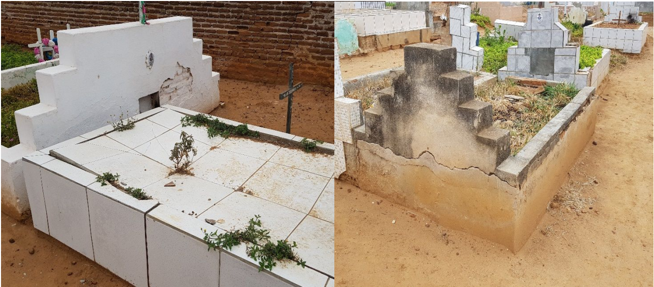
Figuras 4 e 5: A má conservação do cemitério causa fissuras e rachaduras gerando o escape dos gases e necrochorume. Fonte: Autores.
