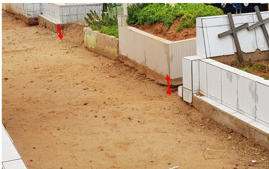
Figura 7: Processos erosivos do solo ocorrido pelo escoamento das águas pluviais no interior do cemitério. Fonte: Autores.
