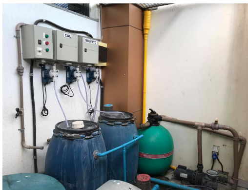
Figura 2: Dosadores e tanque de diluição. Fonte: Borges, 2020.
