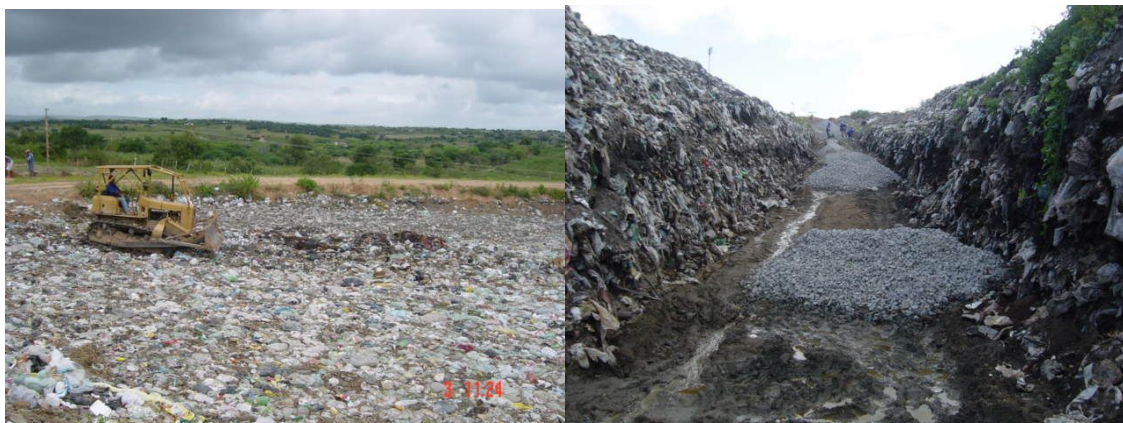
Figuras 2 e 3: Movimentação do maciço de lixo para implantação dos drenos horizontais.
