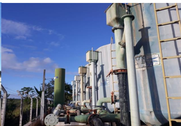
Figura 4: Tubulações de entrada e saída dos filtros Fonte: Moreira, 2020.
