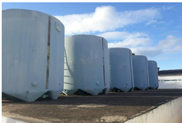
Figura 3: Filtros em fibra de vidro
