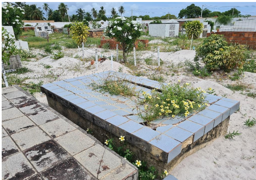
Figura 4. Falta de manutenção dos túmulos. Fonte: Os autores (2022).
