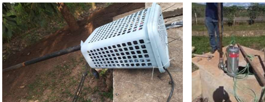
Figura 6 – Gradeamento improvisado para EEE (à esquerda) e substituição da bomba da EEE pelo modelo “submersa”. Própria (2017)
