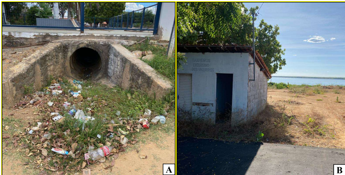
Figuras 8 e 9 - Bueiro desprovido de grade de contenção no centro da Cidade de Parnaguá e banheiro do Parque de Exposição.
