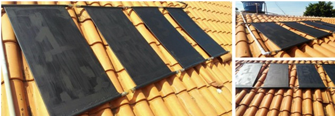
Figura 1. Aquecedor solar instalado em residência da zona rural de Tatuí, estado de São Paulo.
