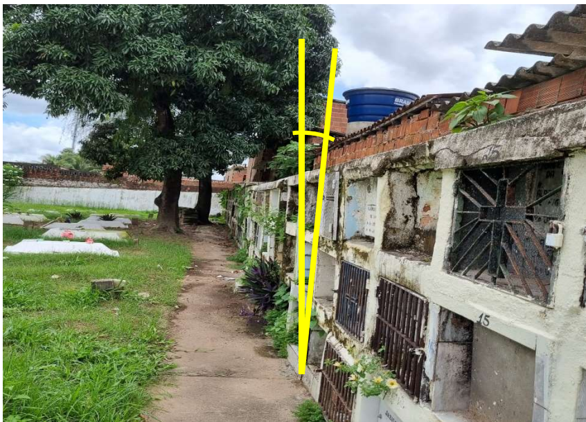
Figura 6: Inclinação do muro que serve de estrutura para as casas.
