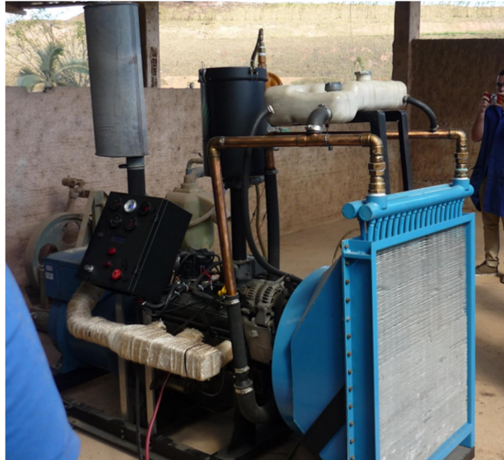
Figura 3: Fotografia do GMG instalado na casa de máquinas do aterro sanitário em Brusque. Fonte: Autores do Trabalho.
