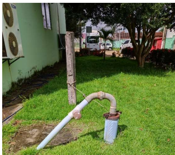
Figura 1: Poço de abastecimento da instituição.
