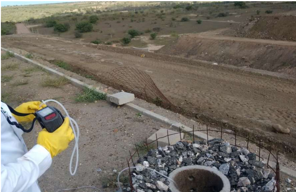
Figura 4: Monitoramento de drenos verticais de gases para esta pesquisa. Fonte: Autor do Trabalho.
